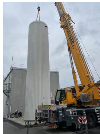
Dank exakter Planung konnte der DEHOUST Speicher problemlos aufgestellt und fixiert werden. (Bilder DEHOUST)
