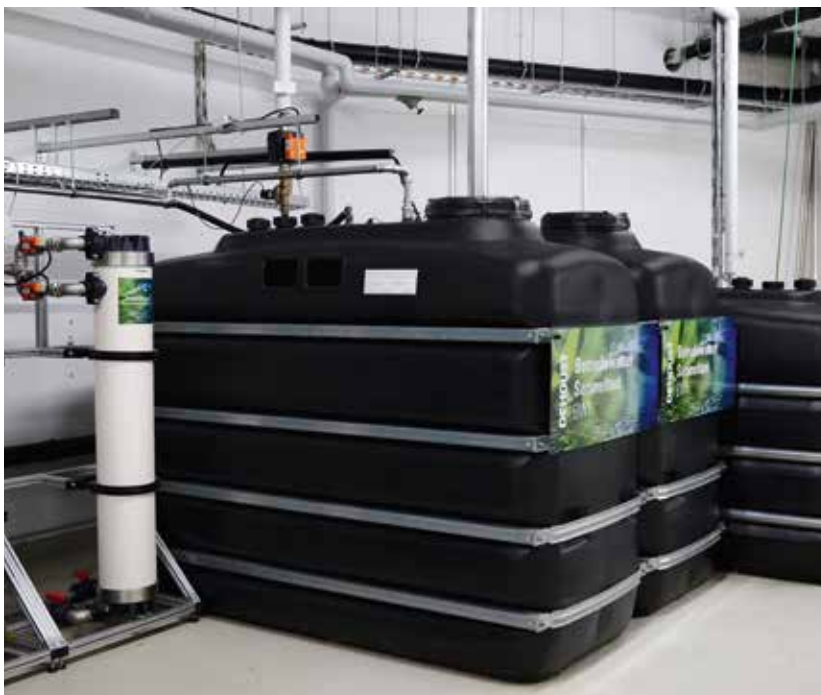
Nach der Aufbereitung steht den Anwohnerinnen und Anwohnern sauberes und hygienisch unbedenkliches Betriebswasser in den PE-Tanks zur Verfügung.
