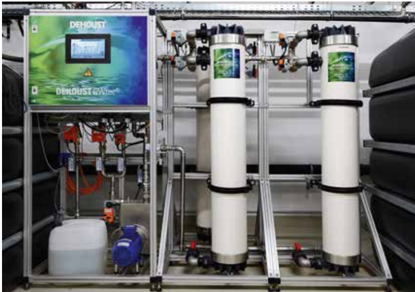
Die Aufbereitung des Abwassers erfolgt in mehreren Schritten. Bei der Ultrafiltration wird das Grauwasser mittels Membrantechnologie ohne Chemikalien aufbereitet.
