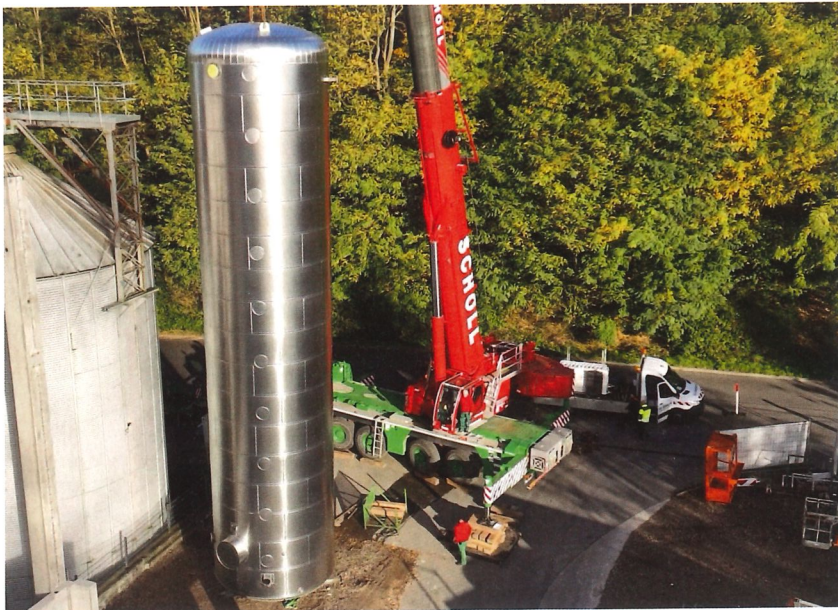
Die Dehoust-Pufferspeicher werden in Größen bis 250 m 3 angeboten und individuell auf Projektanforderungen abgestimmt
