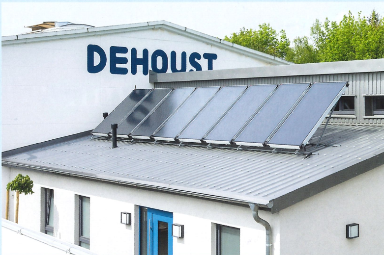
Auf dem neuen Sozialgebäude ist eine Solarthermieanlage mit insgesamt acht Flachkollektoren installiert. Heizung und Warmwasser des Neubaus werden hauptsächlich solar bereitgestellt.
