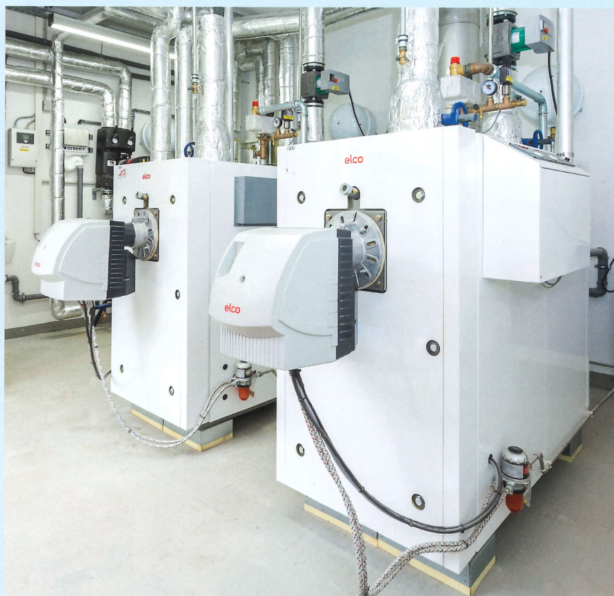
In der Lackierhalle sind zwei 150-kW-Öl-Brennwertkessel installiert. Sie ergänzen die Luft-Wasser-Wärmepumpe. Das neue Heizsystem soll künftig auch die bestehende Produktionshalle mit Wärme versorgen.
