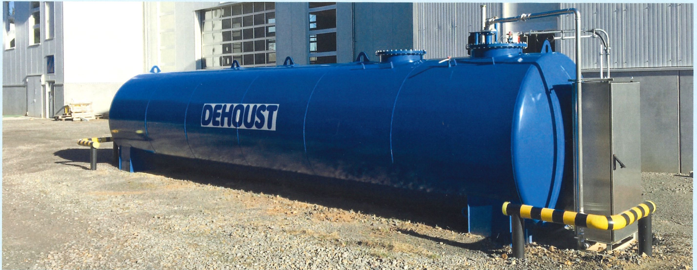
30.000 Liter Heizöl fasst der doppelwandige Stahlzylindertank mit automatischer Lecküberwachung und Tankheizung. Er stellt die Brennstoffversorgung der Brennwertkessel in der Lackierhalle sicher.
