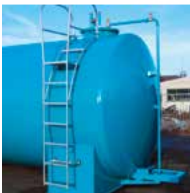
Dieseltank mit Podest und Saugleitung
